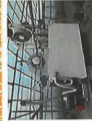
木質バイオマスボイラーの導入
