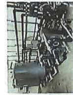
木質資源利用ボイラー
