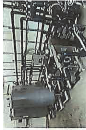
木質資源利用ボイラー
