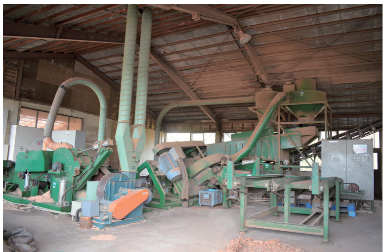
工場内にはおが粉用(左)とザラメ(チップ)用(右)のチッパー(木材破砕機)が設置される
