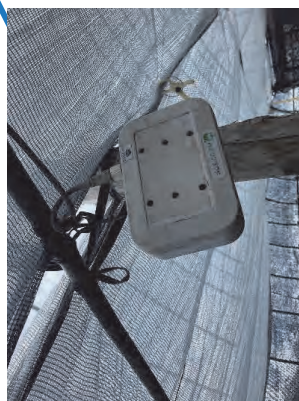
【CO2センサー】 ハウス内のCO2を計測し、換気状況を把握する
