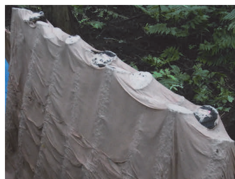
図6 豪雨直後の被覆材状況 (2-3区)
