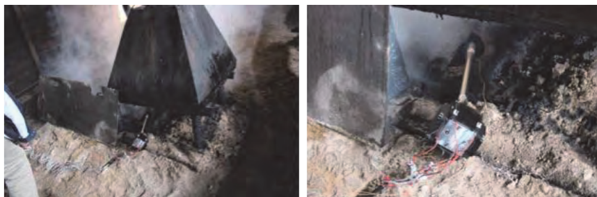
<煙突口 機器設置状況>
